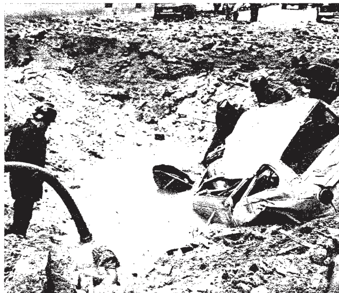
Los bomberos intentan localizar la boca de agua abierta tras la explosión, achicando la que afluye mediante bombas.
